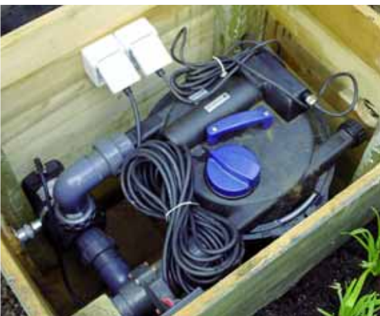
Trykfilter i nedgravet trækonstruktion med låg. Bemærk den tørmonterede pumpe til venstre.
