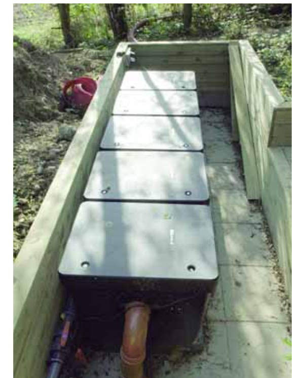
Eksternt tilløbsfilter i nedgravet filterstation med bund af betonfliser og sider af træ. Udslamningen sker via rør til en bagvedliggende grøft.
